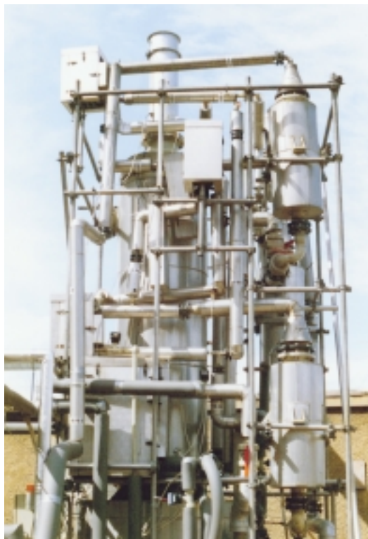
Abb. 3 Offener Sorptions- kreisprozess für die Brüdenwärmever- nutzung in der Malz- fabrik Landsberg. Fo- to: Martin-Luther- Universität Halle- Wittenberg/IW-UT
