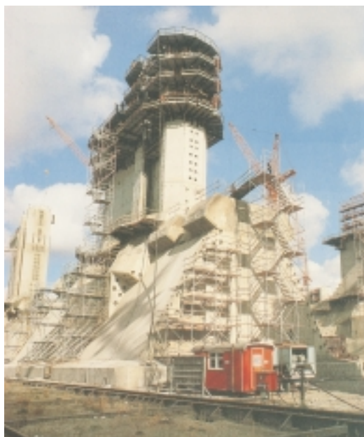
Abb. 2 Pfeiler des Sperrwerks im Bauzustand (30 bis 39 m hoch), die vom Trockendock in die Sperre eingeschwommen werden. Foto wie Abb. 1
